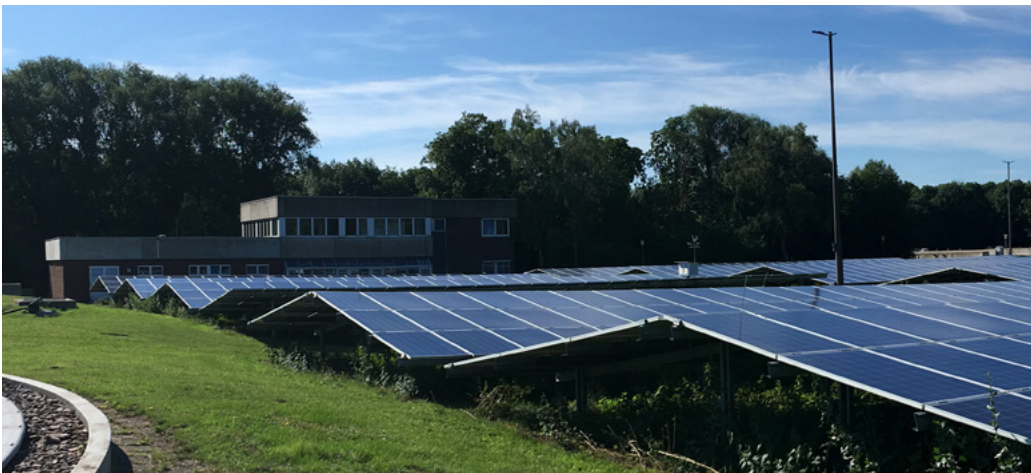
Sinnvolle Flächennutzung durch das Kooperationsprojekt der Stadt Bad Salzuflen und der Stadtwerke an der Kläranlage in der Ziegelstraße.
