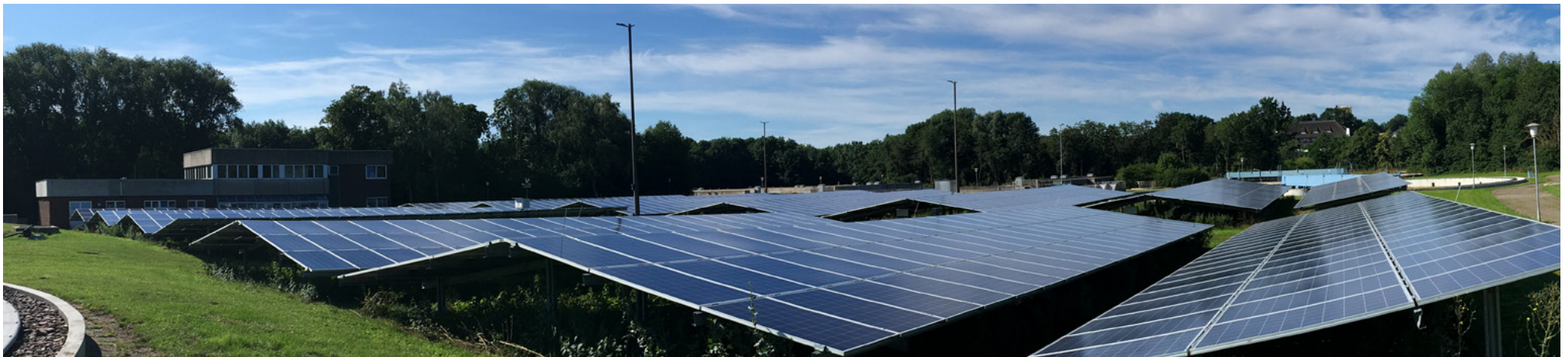
Sinnvolle Flächennutzung durch das Kooperationsprojekt der Stadt Bad Salzuflen und der Stadtwerke an der Kläranlage in der Ziegelstraße.
